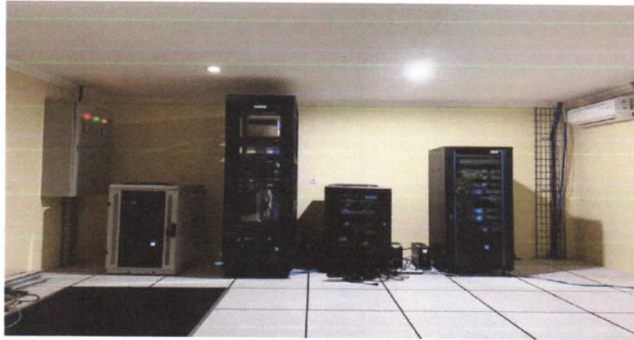
Gambar IV.2 Kondisi Eksisting Data Center Pemerintah Kabupaten Rembang
